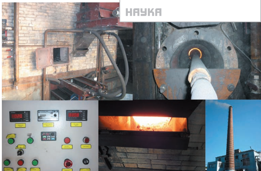
Рис. 3. Котельная, котел ДКВР-10-13, работающий на ВУТ
