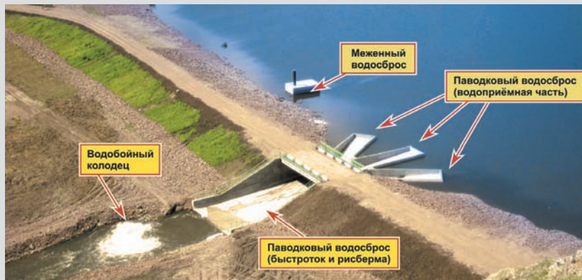
Общий вид ГТС пруда на р. Дудет в с. Тамбар после сдачи объекта в эксплуатацию. Меженный водосброс в работе. Работа водобойного колодца
